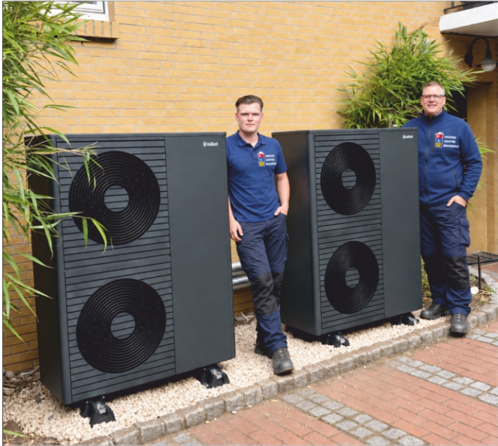
Eine Wärmepumpen-Kaskade für ein 6-Familienhaus erfolgreich umgesetzt.
